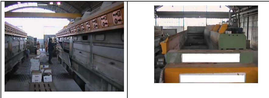
Fig.3: Linee di trattamento superficiale a nastro
