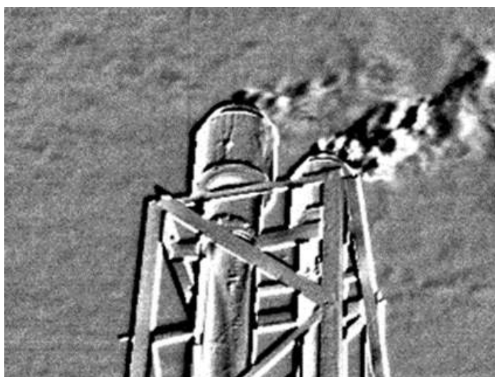
Figura 9.3: Rilievo mediante termocamera dei vent in un impianto di riduzione della pressione
